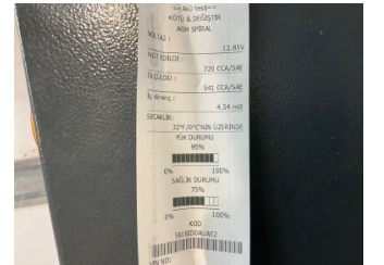
Elektrik donanımı/Pano, Akü > Test Sonucu
