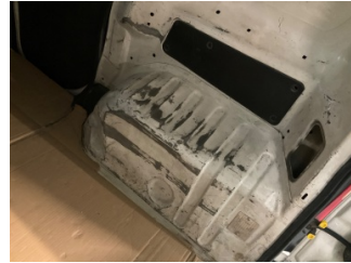
Döşemeler/Kapaklar, Döşemeler/Kapaklar > Hasarlı
