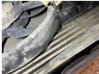
Motorsöğütması, Fan muhafazası > Hasarlı
