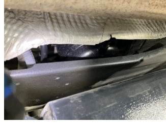
Motor, Yağ filtresi > Sızdırıyor
