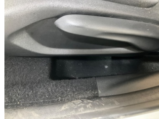
Döşemeler/Kapaklar, Döşemeler/Kapaklar > Yakıcı Madde Ile Zarar Görmüş
