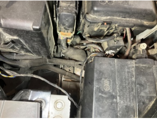
Elektrik donanımı/Pano, Kablo demeti > Standart Dışı Onarım
