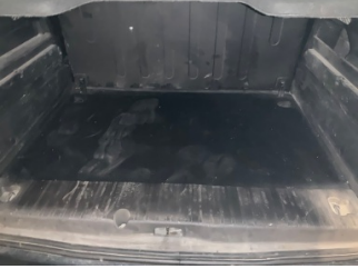
Döşemeler/Kapaklar, Döşemeler/Kapaklar > Deforme Olmuş
