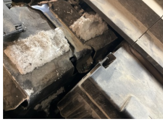
Elektrik donanımı/Pano, Akü > Onaysız
