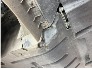
Motor, Alt muhafaza > Hasarlı
