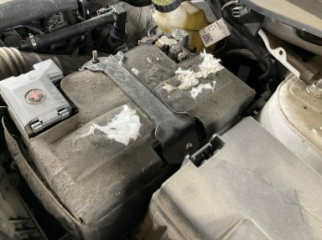
Elektrik donanımı/Pano, Akü > Deforme Olmuş
