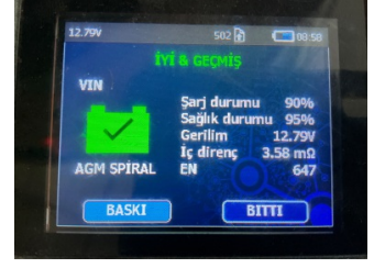
Elektrik donanımı/Pano, Akü > Test Sonucu
