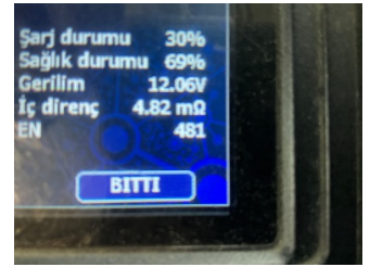
Elektrik donanımı/Pano, Akü > Test Sonucu
